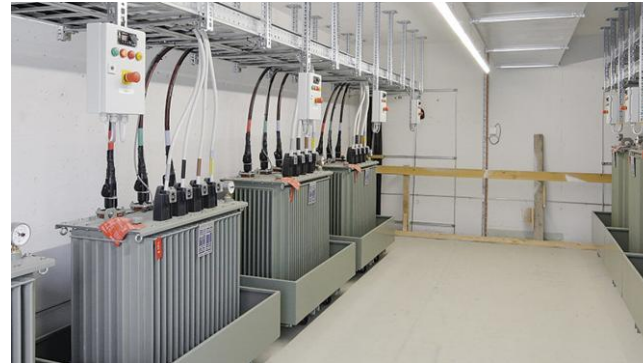
Raccordement au réseau
